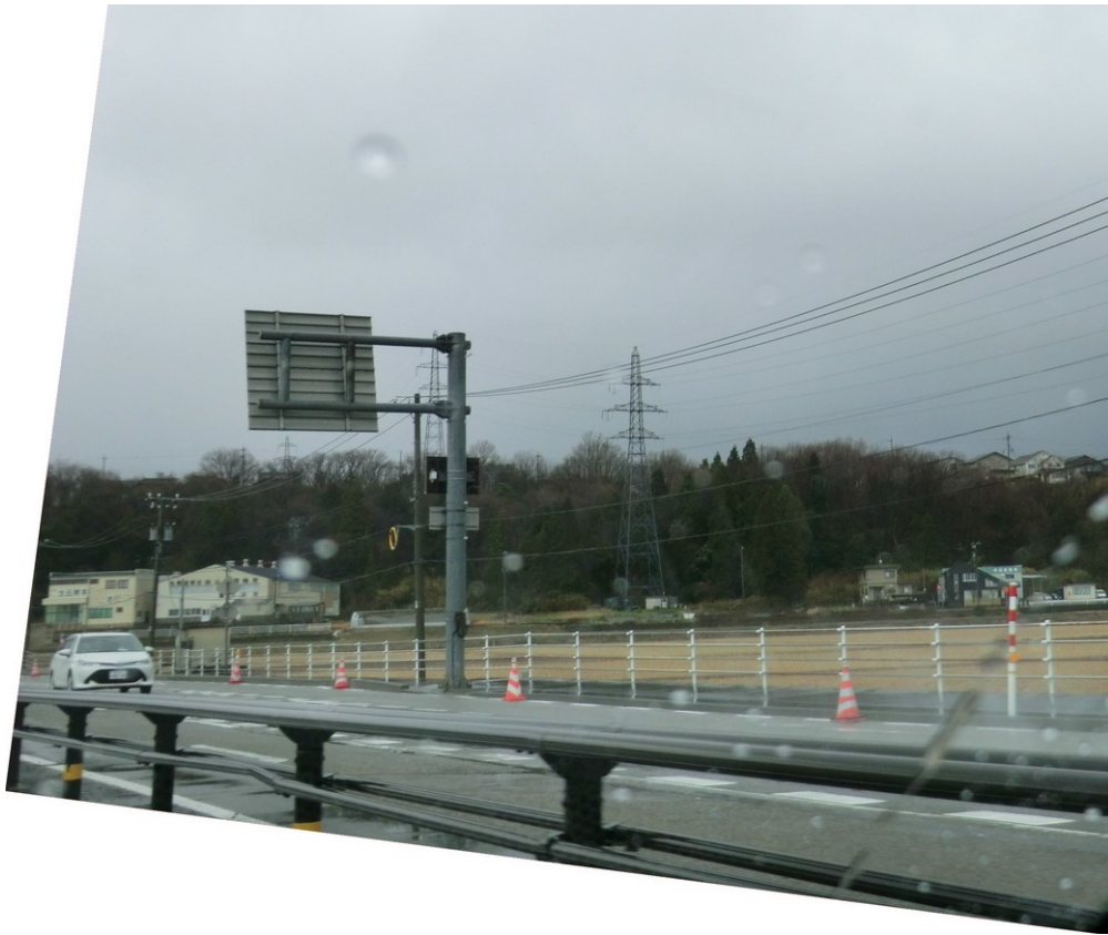
4車線のうち東側のみ.路面にも凹凸が生じていた.
