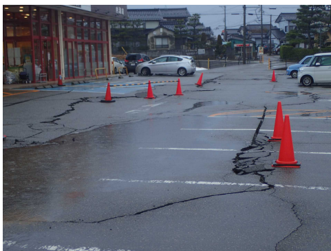
舗装の隆起（内灘町大根布）
