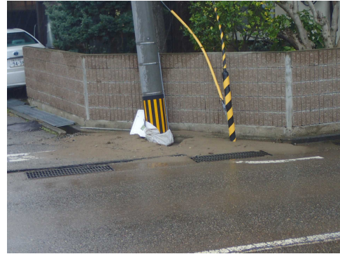
電柱の沈下（内灘町鶴ヶ丘）
