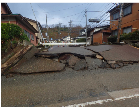
道路の寸断（内灘町西荒屋）
