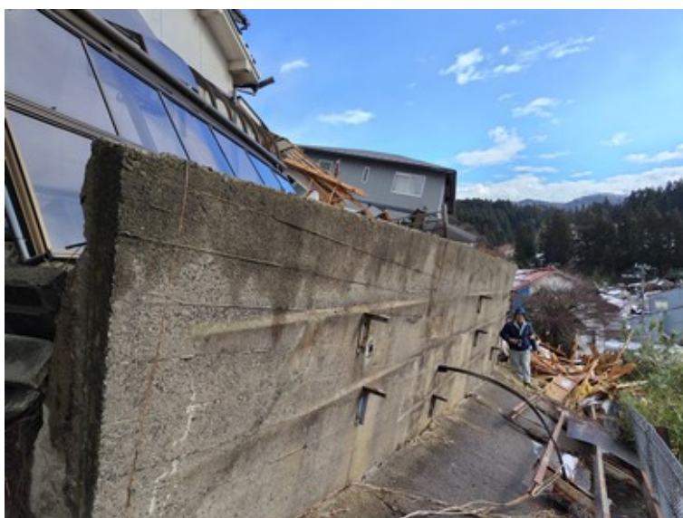
一応対策はされていたが,崩壊に至っている。
