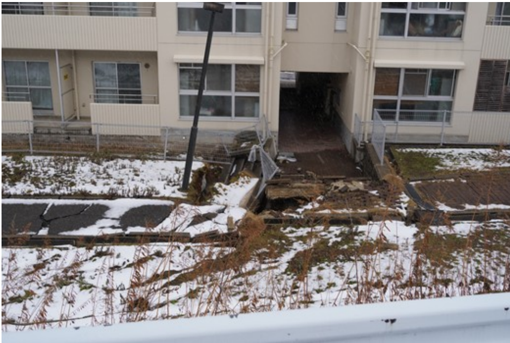
尾根部分の市営住宅の地盤の被害を受けている
