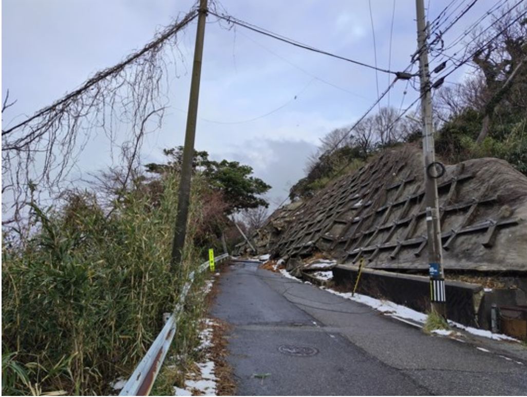
ロックボルト対策斜面の崩落
