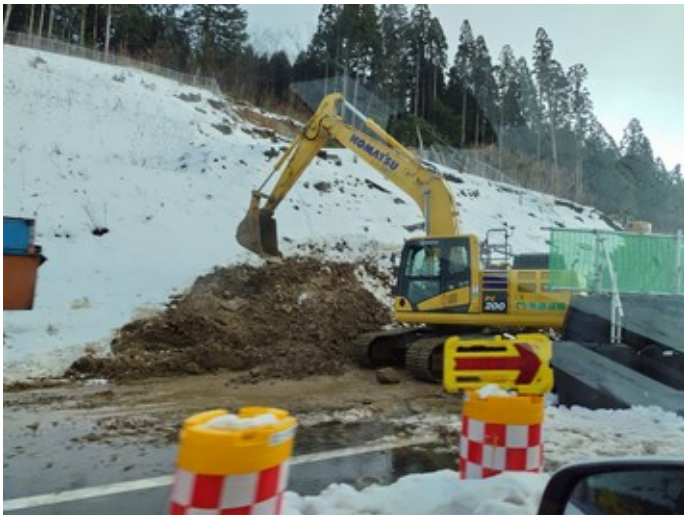
盛土以外の斜面での崩落も認められる
