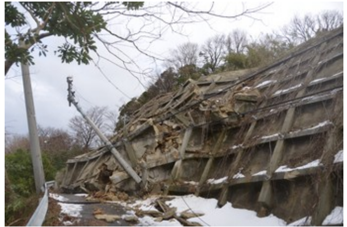
崩れたブロック
