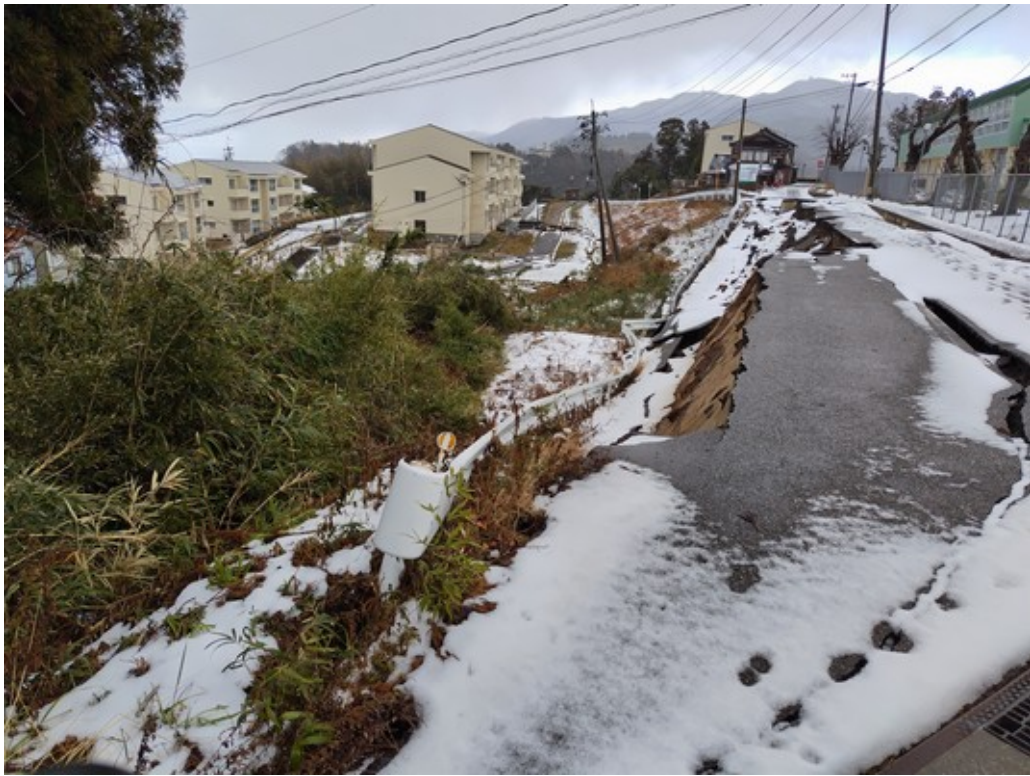
手前は谷埋め盛土(市営住宅の西側の谷埋め盛土では戸建て住宅の被害あり)
