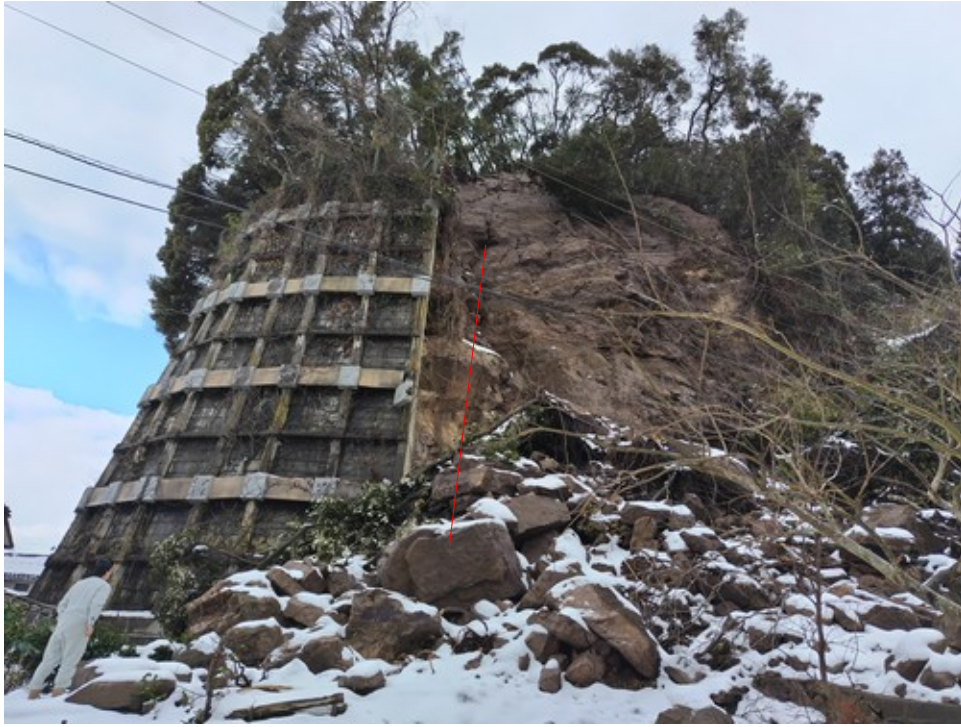
崩落保護施設のある風化岩の崩壊(き裂に飛んでおり, 赤線付近に連続き裂あり)
