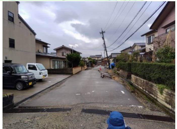
グラウンド西側の道路の変状
