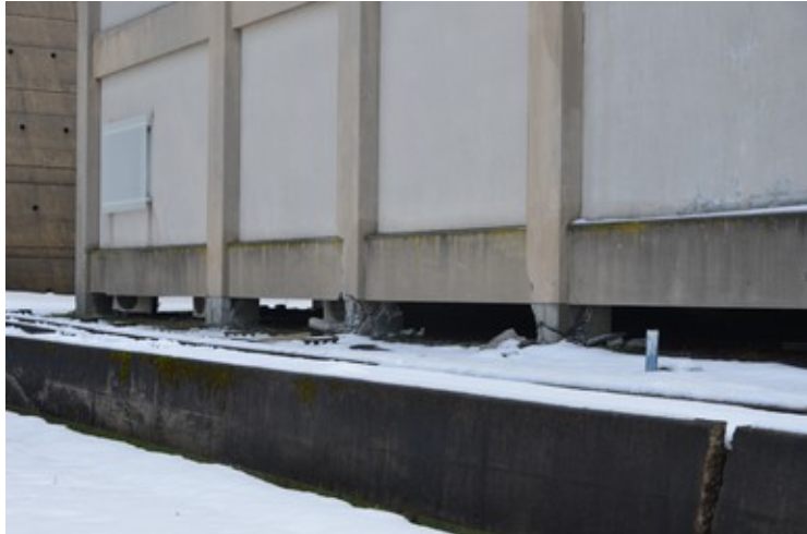
建物基礎の被害
