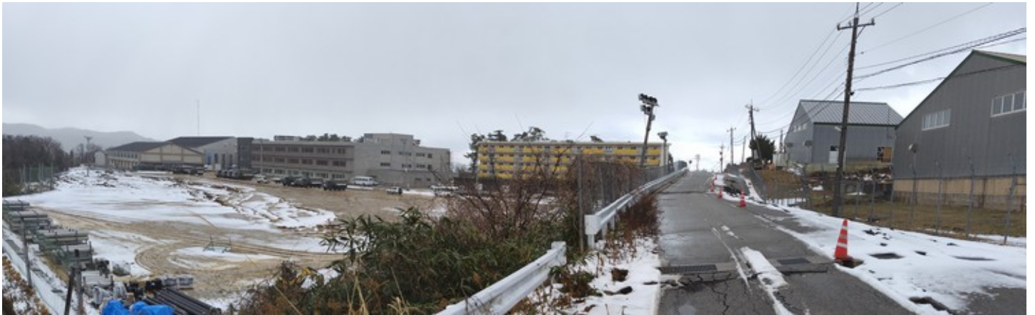
青葉ヶ丘住宅の裏手,穴水高校のグラウンドの亀裂(盛土部分と思われる)
