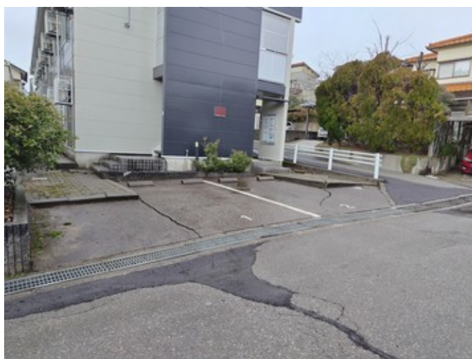
45.道路両側とも大きな亀裂と段差
