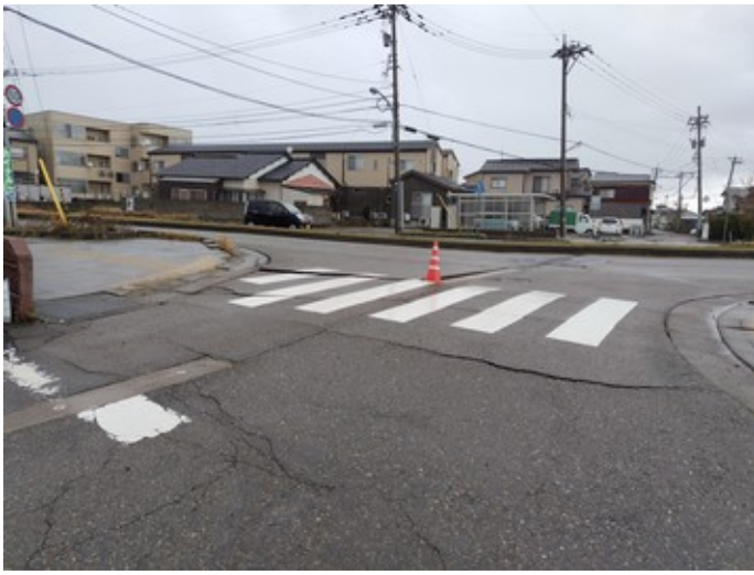
47.内灘町,46 からの変状は続いている
