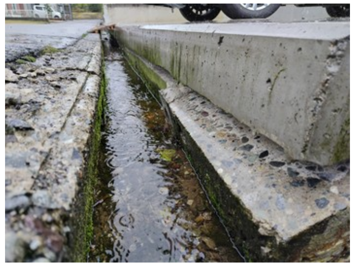
16.コンクリート床板のズレ
