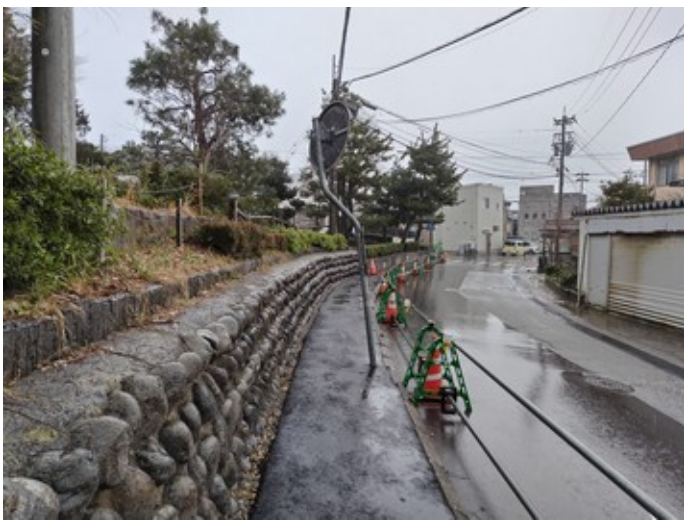
14.小学校下の道路の変状
