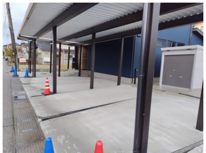
38. コンクリート床板のずれ(電柱傾斜多数)
