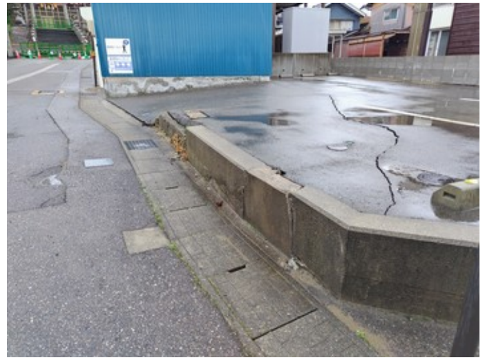
22.駐車場の亀裂
