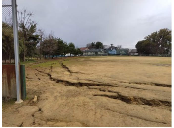
4. 北西のグラウンドの亀裂
