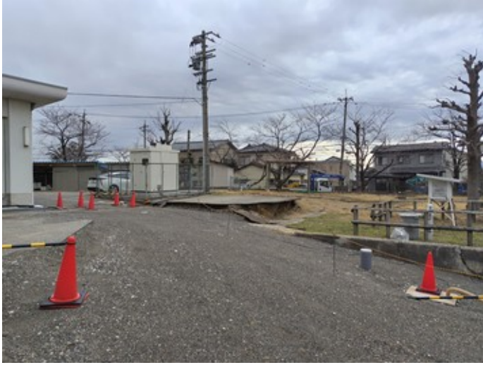
1. 栗崎小学校南東端(敷地盛土の沈下)
