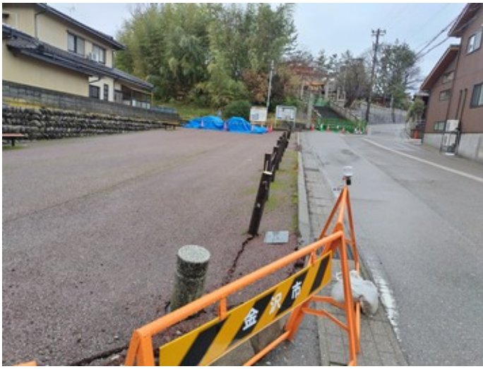
21.液状化によるポールの傾き
