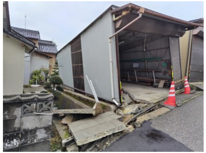
31.大きな段差が生じている
