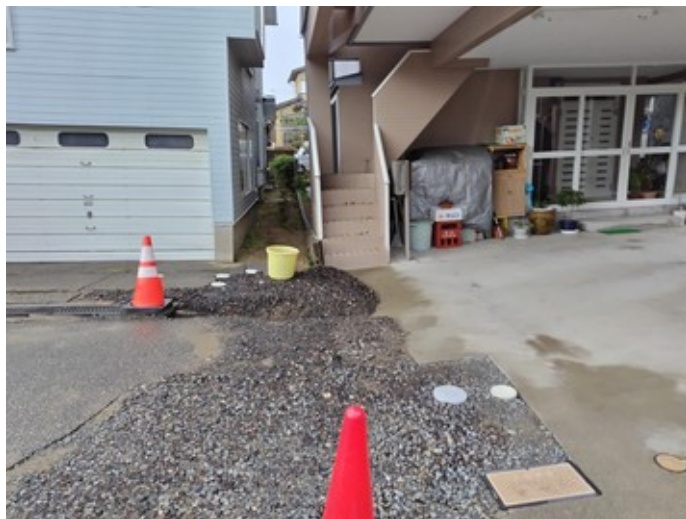
42.右の建物が傾き,下方の左の建物を押している
