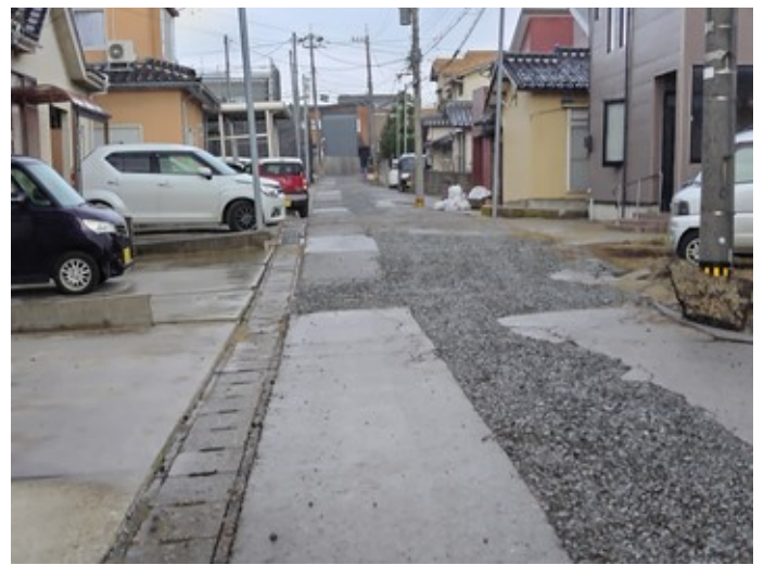
11.液状化による沈下が認められる
