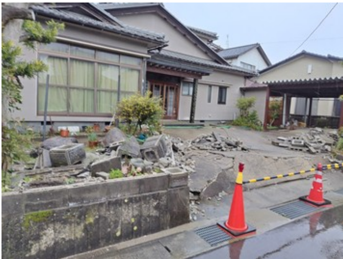
17.液状化による変状(下方にずれている)
