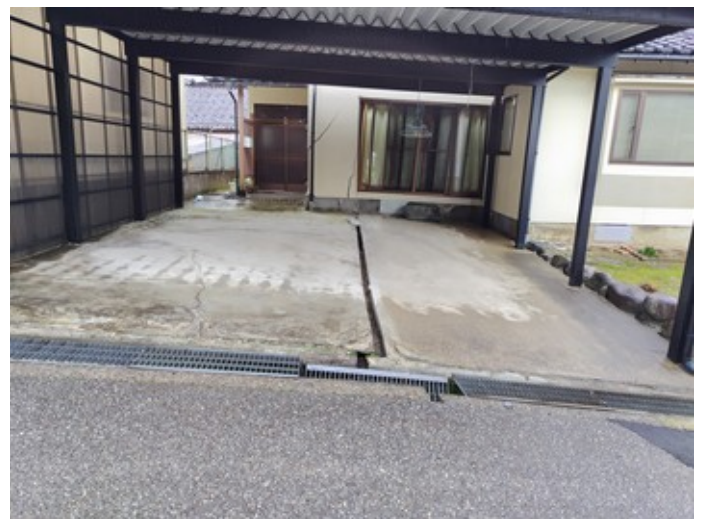
26.宅地内の亀裂(流動またはすべりによる)
