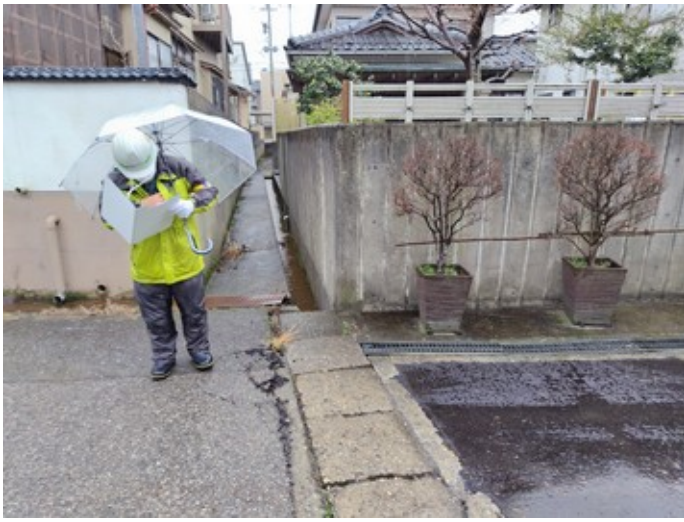
13.水路付近で液状化の痕跡あり
