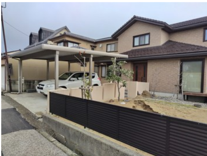
7. 家屋庭の亀裂(6から続いていると思われる)
