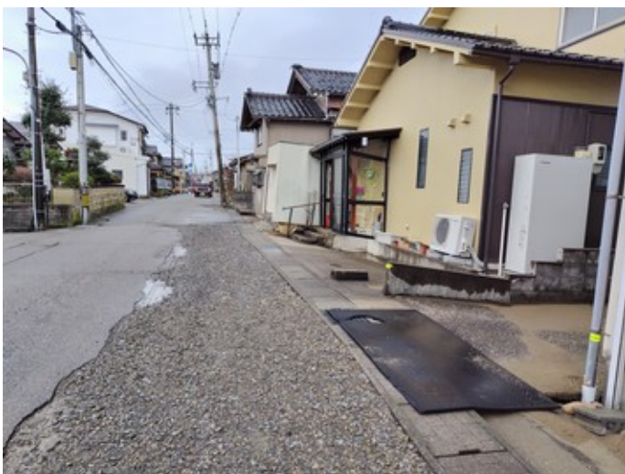
39. 家屋の沈下および傾斜, 電柱の傾斜
