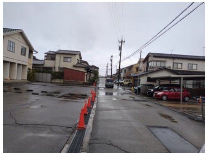
51. アパートの駐車場の亀裂(7から続いている)
