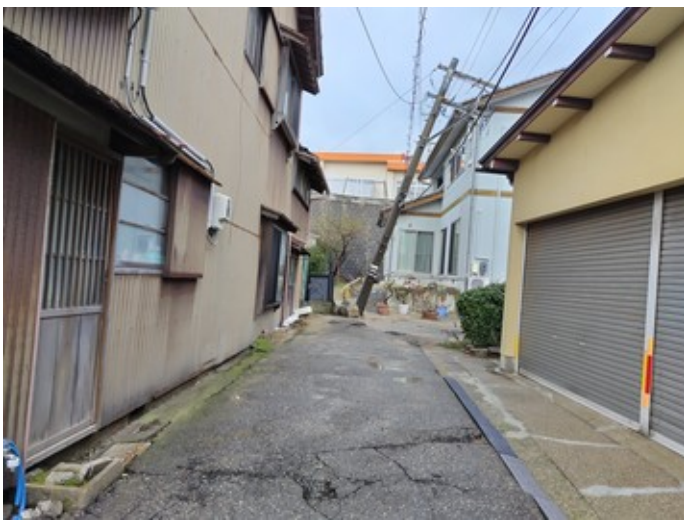
33.電柱の傾き,道路の亀裂
