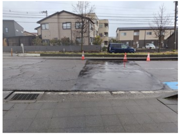
48. 内灘町,43 からの亀裂はここまで続いている
