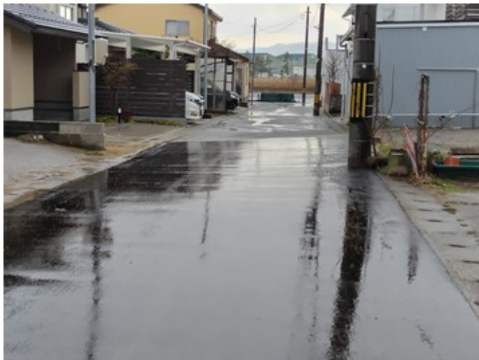
12.補修されているものの沈下は大きい
