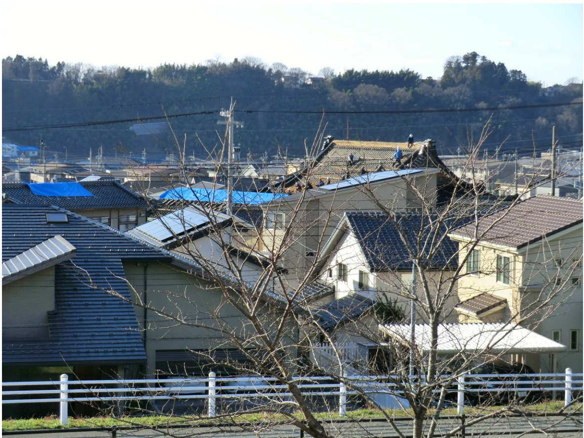
主要道路を挟んで下流側の屋根瓦の被害が他の場所に比べて多い。(撮影:高原)
